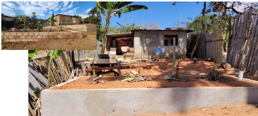
Fig. 15 - Vista do plantio de bananeiras nos TEVap instaladas. Observa-se que o lado externo das paredes foi rebocado. Fonte: MAIS AMBIENTE.
