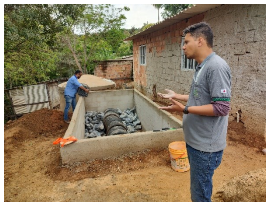
Fig. 17 B – Eng. Alvânio Ricardo Neiva Júnior (Mais Ambiente) prestando explicações detalhadas sobre a montagem do TVap. Fonte: RMPC.
