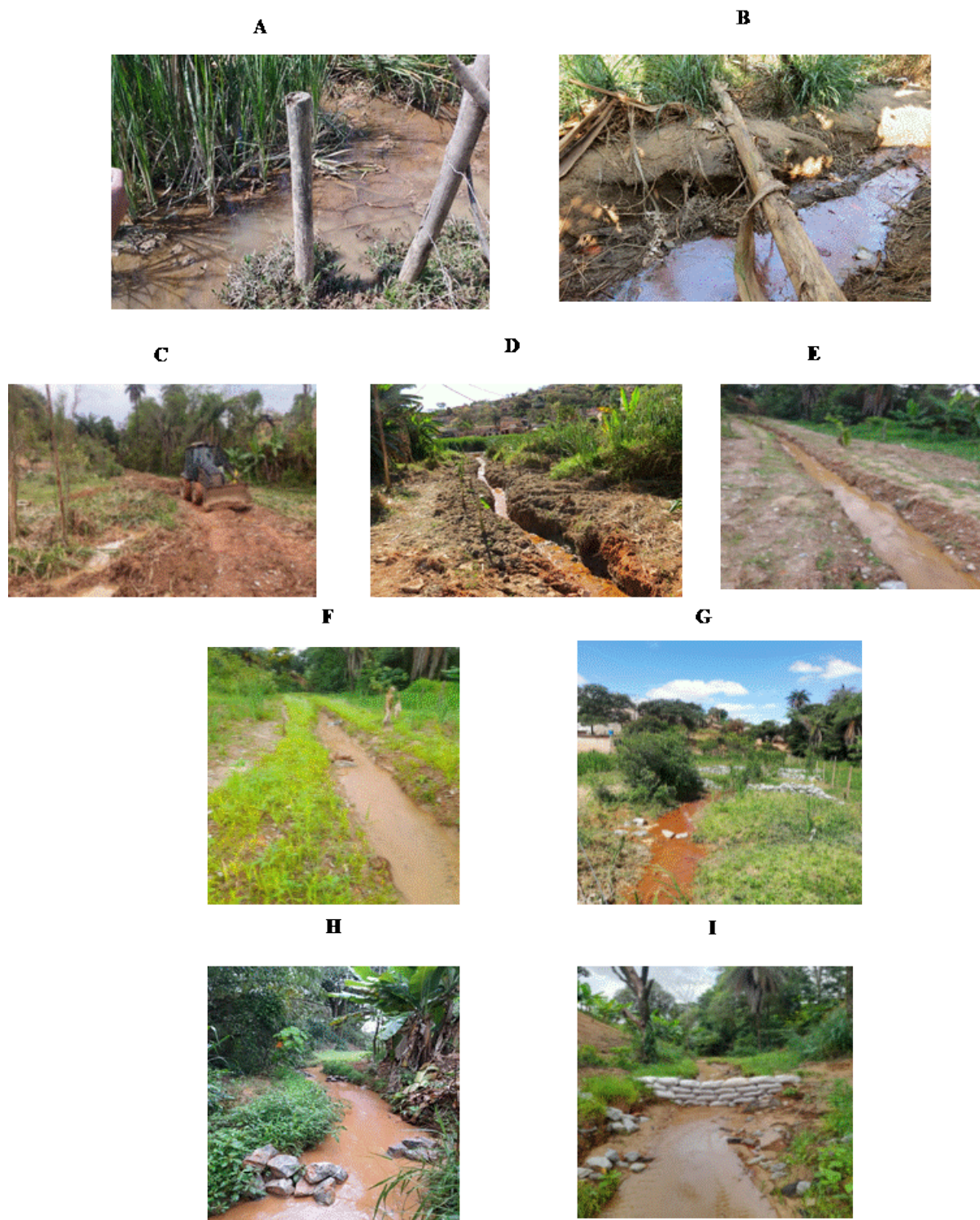
Fig. 5.1 - Nascente N2 A e B : Antes da intervenção (toda a área e ruas alagadas). C : Início da construção dos drenos. D e E : Drenagens. F : Plantio nas margens. G, H, I : Barreirinhas de contenção de sedimentos.
