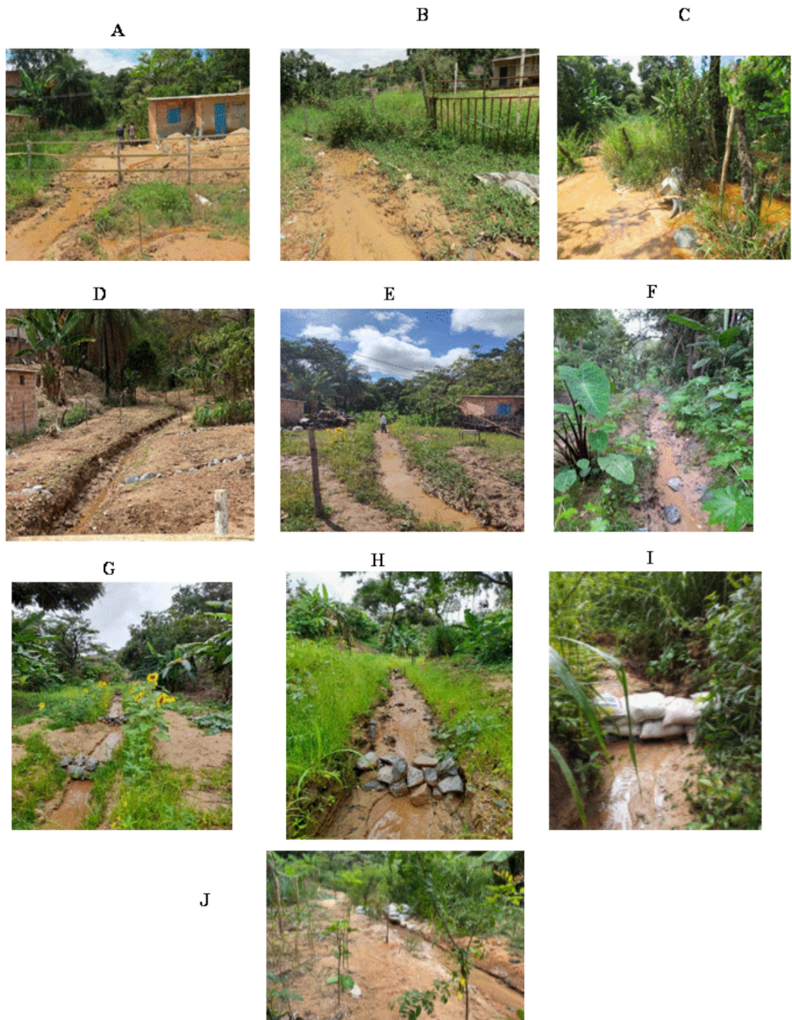
Fig. 6.1 - Nascente N3 A, B e C: Dreno na rua antes da intervenção. D: Abertura de dreno (550 m). E e F: Dreno em funcionamento com plantio de herbáceas nas margens, G H e I: Barreirinhas de Contenção (2022). J: Espécies arbóreas plantadas, aos 6 meses e Barreirinhas (outubro de 2023).
