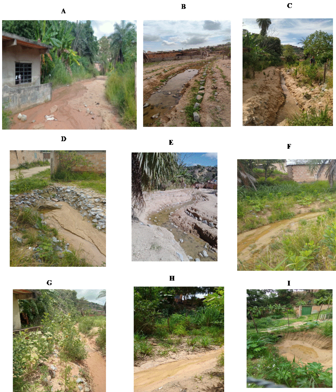
Fig. 7.2 - Nascente N4: Rua do Areal. A: Areal antes da intervenção. B e C: Abertura de drenos com estabilização com enrocamento e plantio, barreirinhas. D: Manilha. E e F: Estabilização mata milar. G e H: Dreno estabilizado com mata ciliar, em 2024. I: Barragem.
