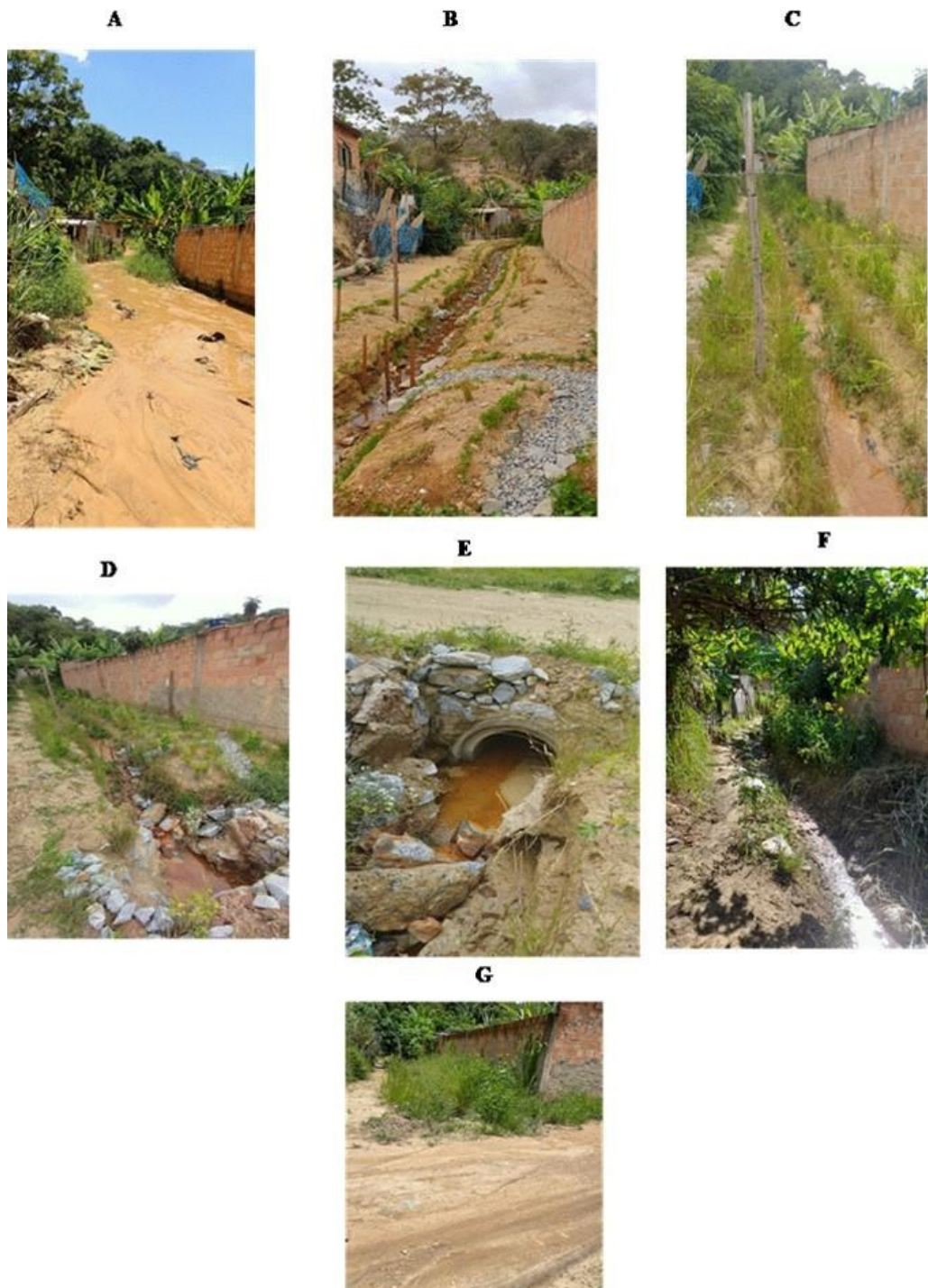
Fig. 7.1 - Nascente N4 - Rua das Águas e Av. Vitória A: Rua das Águas e Av. Vitória, mostrando as áreas inundadas, antes da intervenção. B e C: Dreno com estabilização com plantio e barreirinhas. D e E: Drenagem com manilha e proteção com enrocamento. F: Rua das Águas em janeiro de 2024, G: Rua das Águas e Av. Vitória em janeiro de 2024 (comparar com Fig. 7.1 A ).
