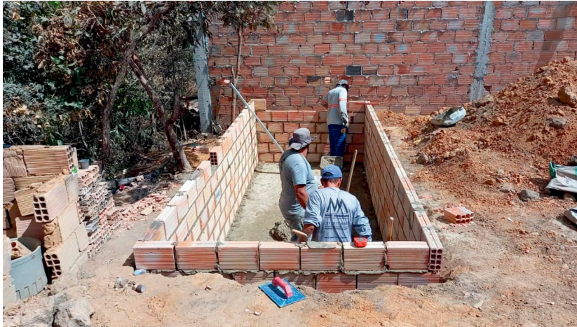
Fig. 8 - Vista da construção das paredes de alvenaria da fossa de um TEVap na rua Felicidade, Comunidade Vitória – Projeto Izidora. Fonte: MAIS AMBIENTE.
