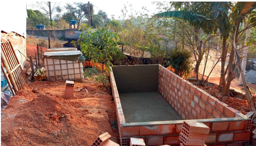
Fig. 9 - Vista das paredes da fossa de um TEVap sendo rebocadas com massa forte e aditivo de impermeabilizante na rua Carolina de Jesus, Comunidade Vitória – Projeto Izidora. Fonte: MAIS AMBIENTE
