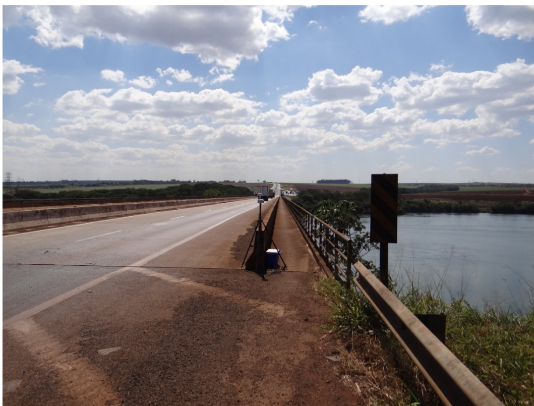
Fig. 11 – Ponte sobre o rio Grande, na BR 050 (autoestrada), do lado paulista. Data de aquisição: 07/08/12; hora: 12:57 h.
