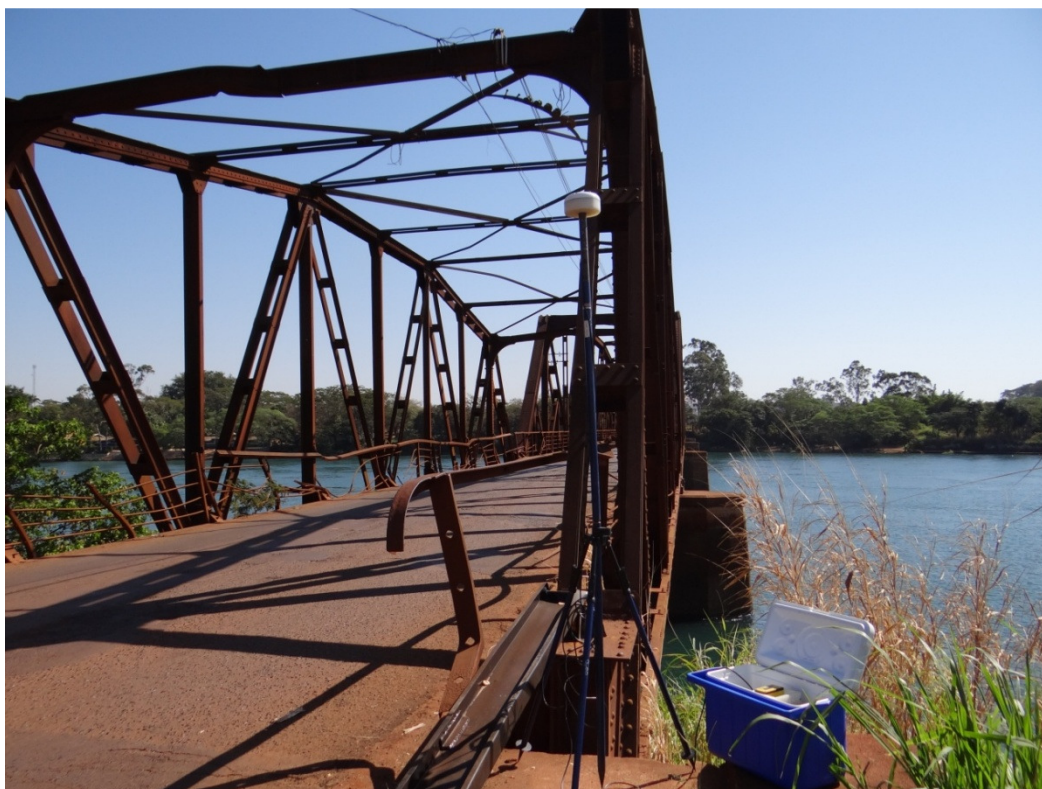
Fig. 06 – Ponte velha sobre o rio Grande, do lado paulista, lado direito para quem vai para Minas Gerais. Data de aquisição: 07/08/2012; hora: 10:21 h.
